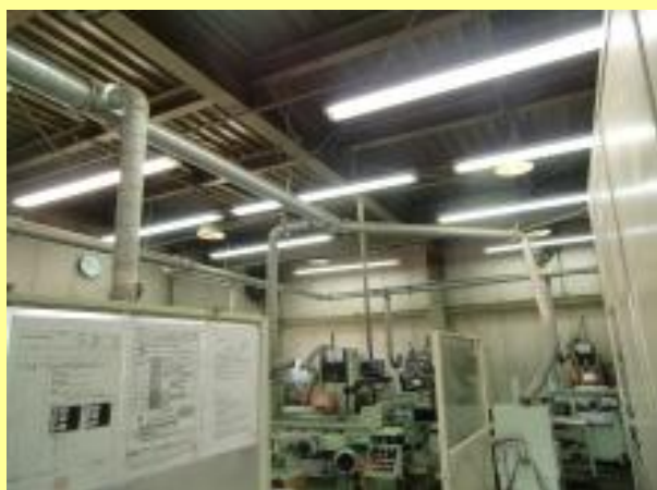
＜施工前＞工場全体を照らす配置。 蛍光灯110wと水銀灯も設置してある。 通路部分も明るくする必要はあるか！？
